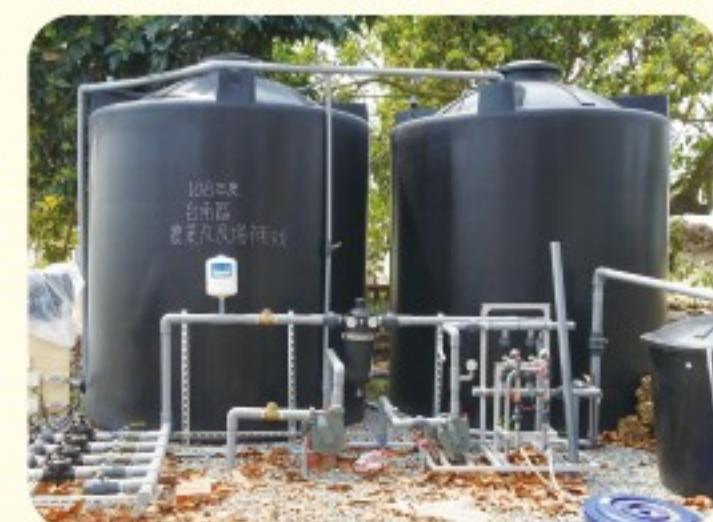
◀ 調節控制設施
